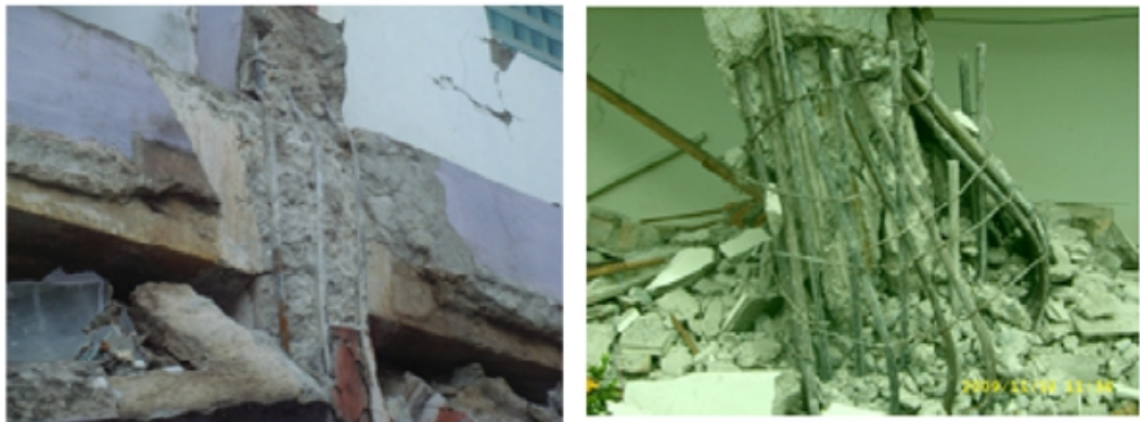
Gambar 4. Detailing penulangan yang tidak sesuai standart
