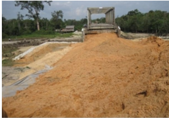
c. Pekerjaan timbunan di belakang abutmen Gambar 2. Kegagalan struktur pondasi abutmen
