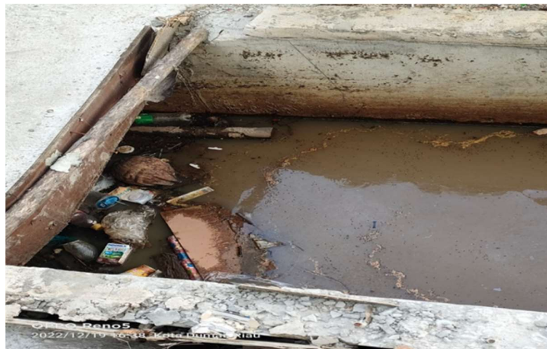
Gambar 1. Kondisi drainase yang tersumbat akibat sampah
