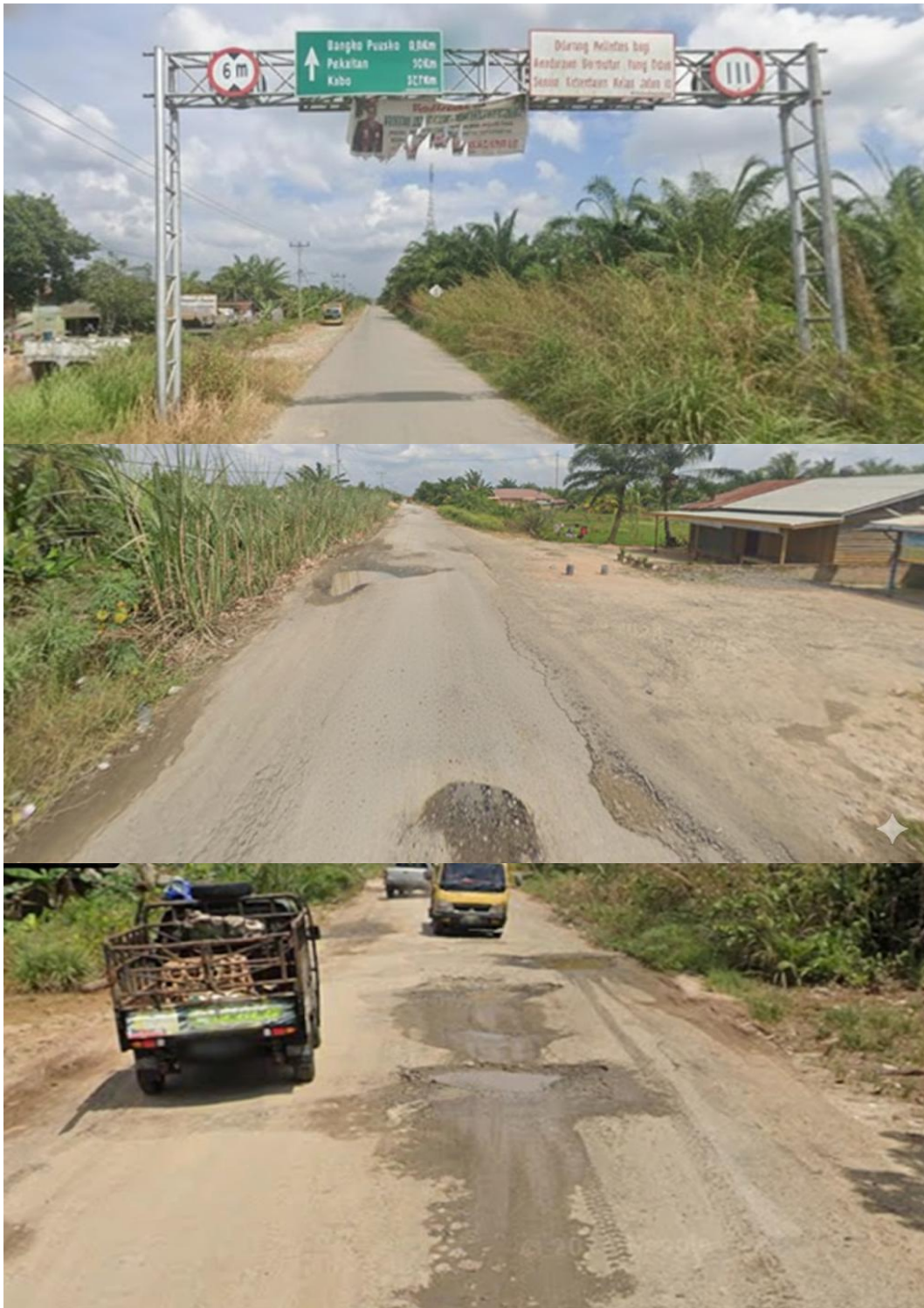
Gambar 1. Kondisi eksisting Jalan Simpang Poros menuju Kecamatan Bangko Pusako
