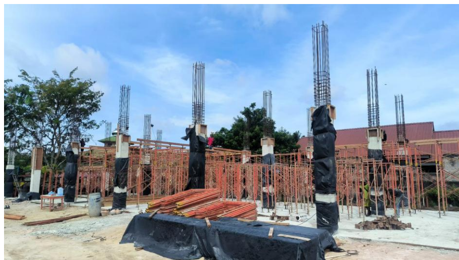
Gambar 2 Area proyek tanpa rambu-rambu keselamatan
