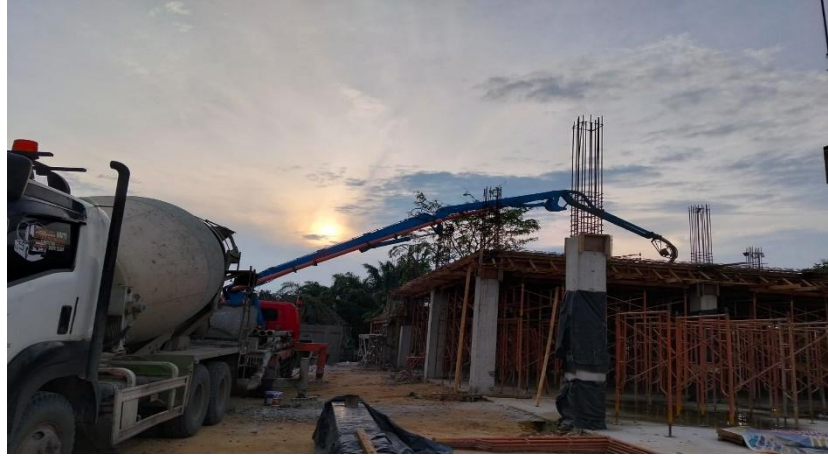
Gambar 4 Area kerja dengan potensi bahaya tinggi tanpa penandaan keselamatan
