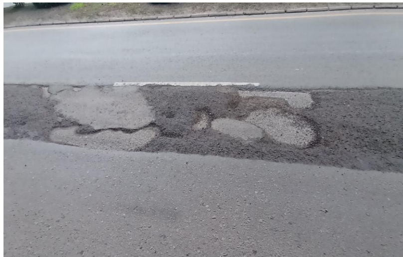
Gambar 4 Kerusakan Cacat Permukaan berupa lubang pada konstruksi perkerasan Sumber : Dokumentasi Penelitian
