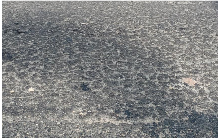
Gambar 3 Kerusakan Retak Kulit Buaya pada konstruksi perkerasan Sumber : Dokumentasi Penelitian
